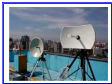
antenas de microondas
